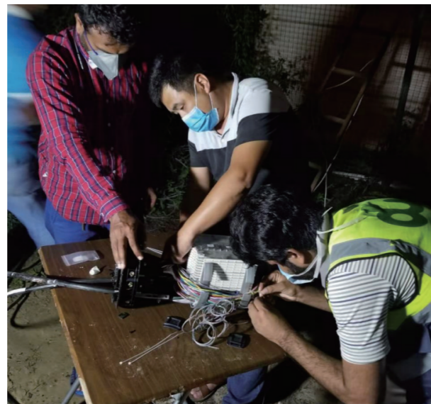
2020 年 3 月 29 日，中国通信服务阿联酋迪拜公司 DU 线路项目部工作人员在阿拉伯联合酋长国迪拜市 Wasan 方舱医院进行光缆布放和熔接工作
